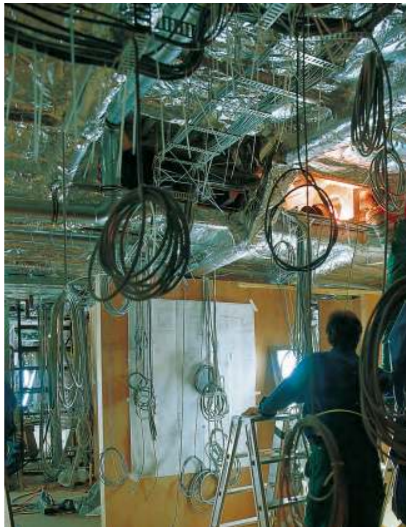
Kabelinstallation: Sieht nach Chaos aus, verläuft aber strikt nach Plan
